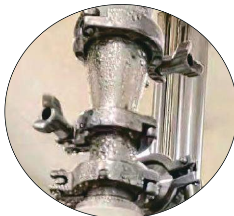
不锈钢接头表面挂满冷凝水珠
